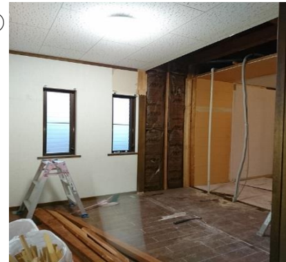
③ 納戸と洋室との間の壁がなくなり、床の工事に入ります。
